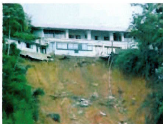
Figura 7:- Deslizamento de um Talude
