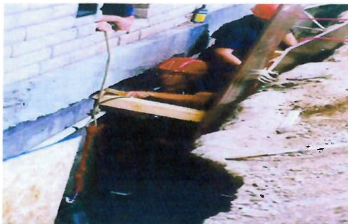
Foto 9: Escoramento de muro. Onde vemos em trabalhador com luva e outro sem luva.
