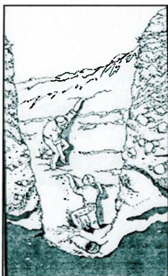
Figura 32 - Acesso ou saída inseguros sem escada.
