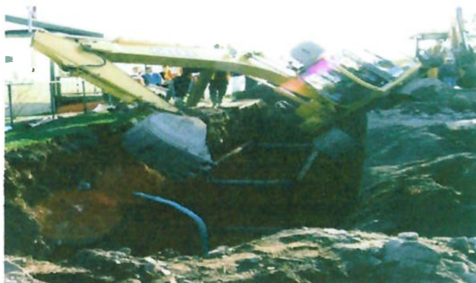
Figura 11 Acidente com veículo (retro escavadeira) por falta de proteção e sinalização nos taludes.
